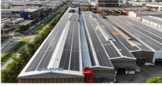
Fabrika Çatı GES
