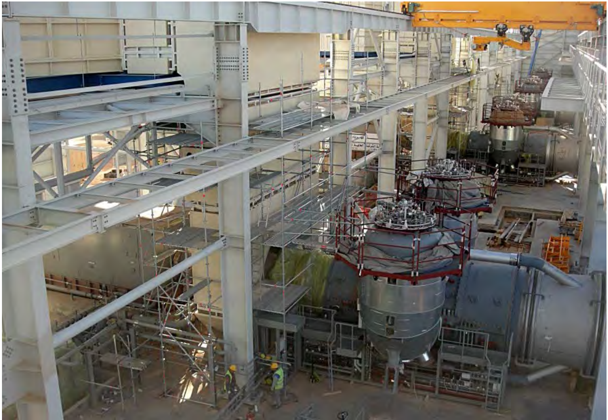
Obari 4x160 MW Gaz Türbin Enerji Santrali Projesi - Obari, Libya
