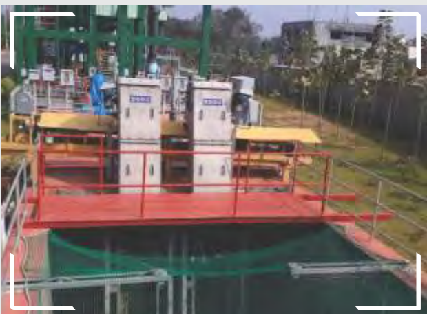
5 MLD STP Kadugodi. BWSSB, Bengaluru, India
