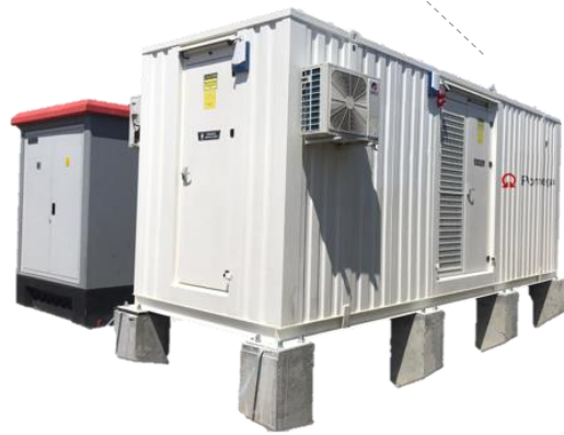
Enerji Depolama Sistemi
