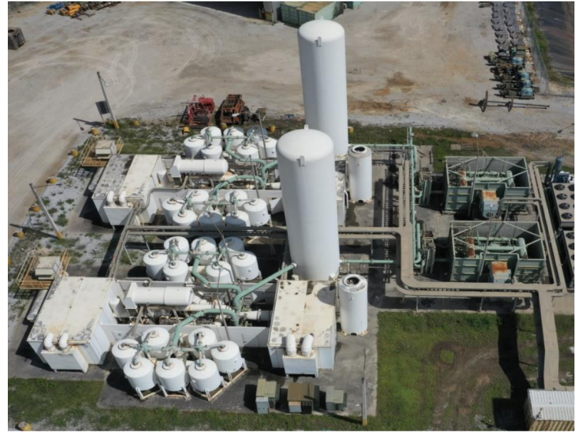
Las Lagunas Oxygen Plant
