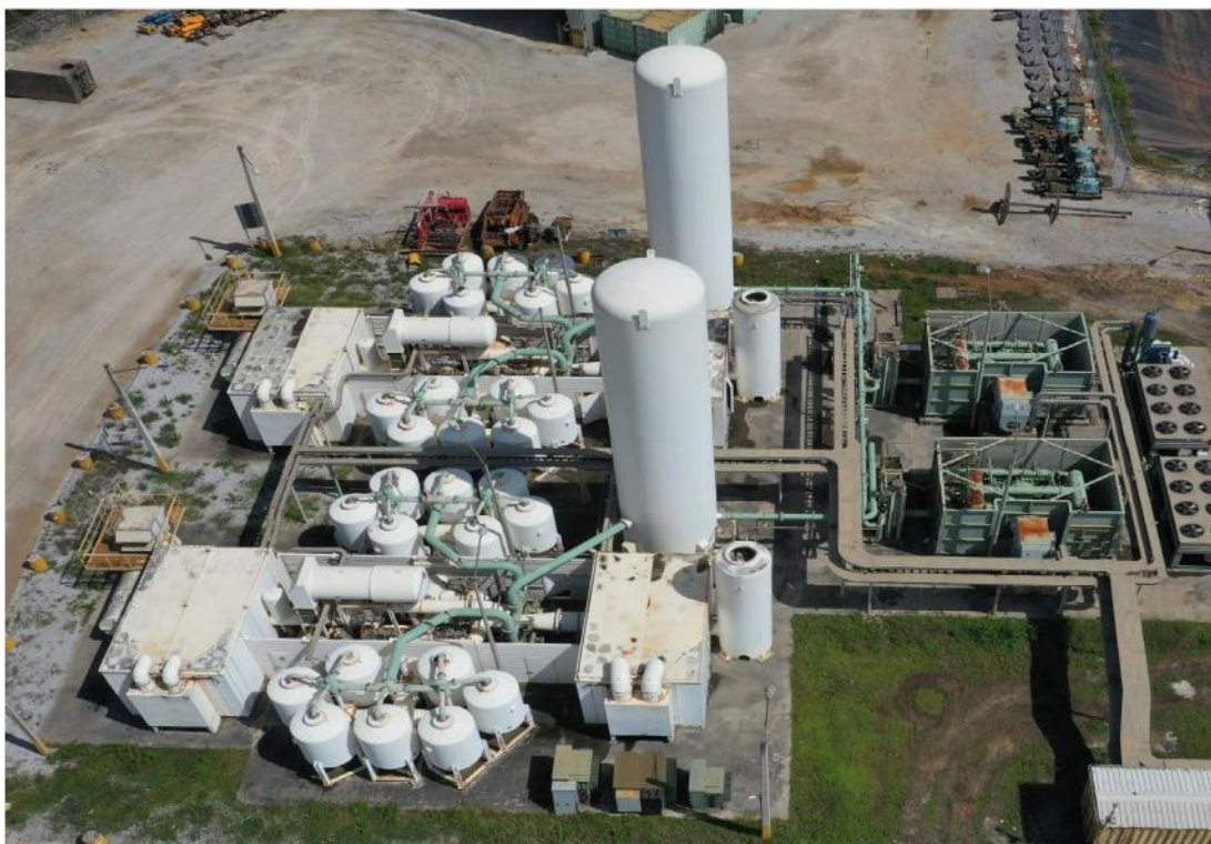
Las Lagunas Oxygen Plant
