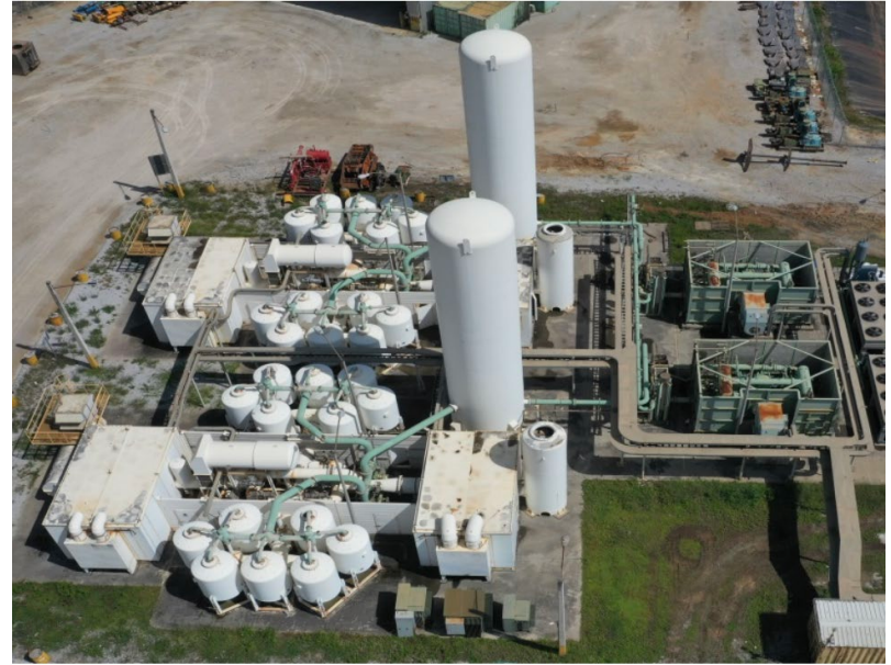
Las Lagunas Oxygen Plant
