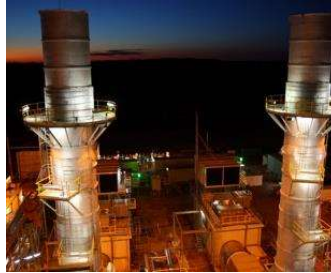
Bypass & HRSG Exhaust System
