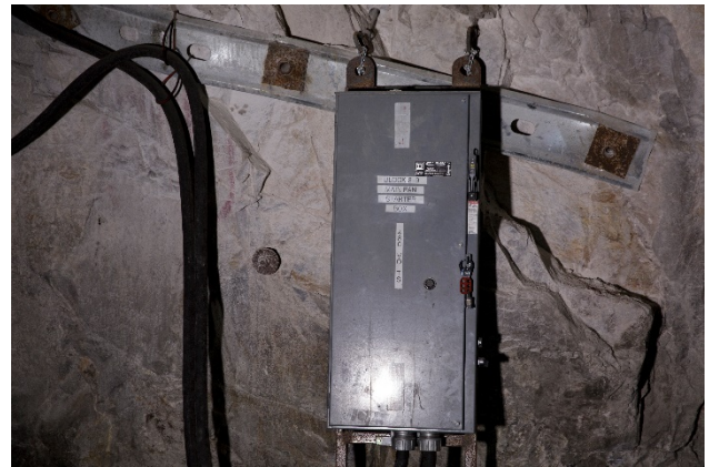
Photo 4 –Starter box for ventilation fan
