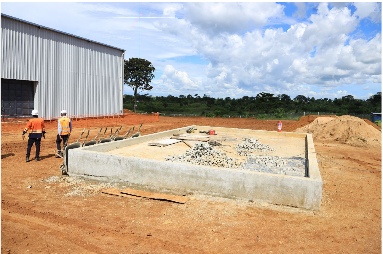
Figure 7: Makuutu stage 1 Demonstration Plant agglomerator pad.
