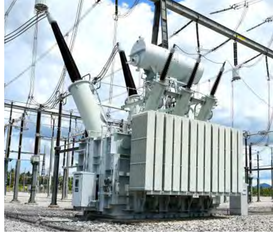
YG/ÇYG Güç Transformatorü
