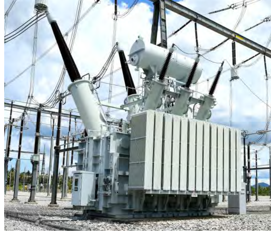
YG/ÇYG Güç Transformatorü
