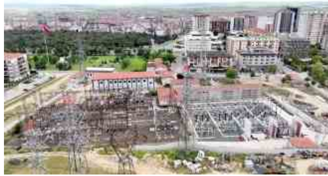
Çorlu Trafo Merkezi
