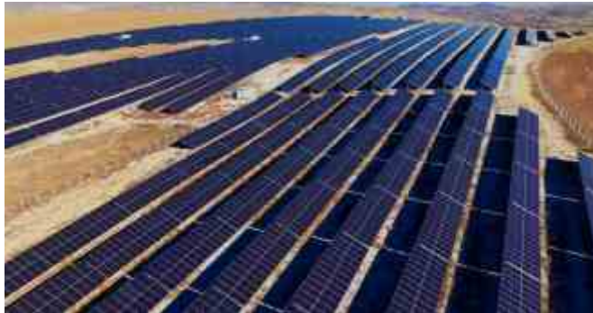
Turkcell Yozgat GES 2
