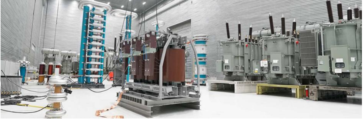
Astor Enerji Test Laboratuvarından bir bölüm
