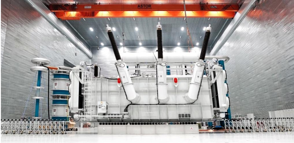
Astor Enerji Test Laboratuvarından bir bölüm
