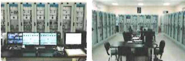
İstanbul Çağlayan 380kV GIS SS
