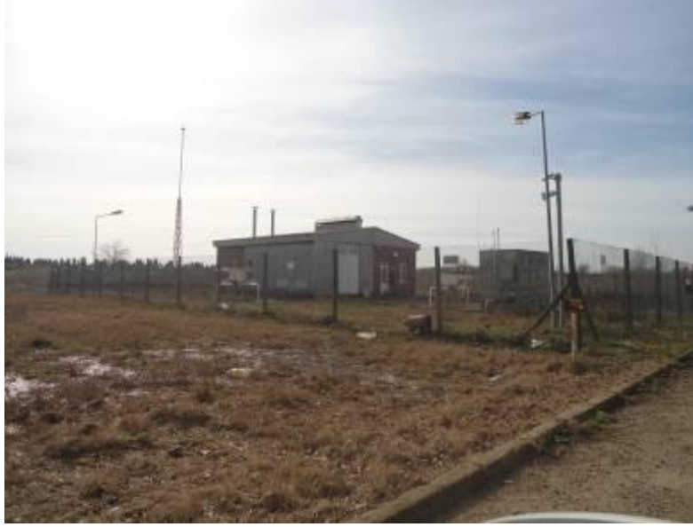
LPG Tesisi ve Doğalgaz basınç düşürme istasyonu
