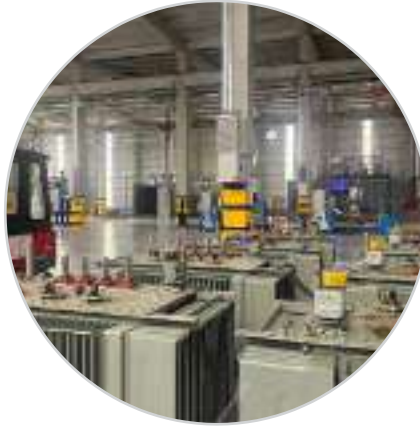
Dağıtım transformatörü fabrikası devrede
