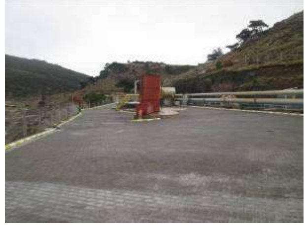
Boru Hattı ve Re-Enjeksiyon Pompası 1
