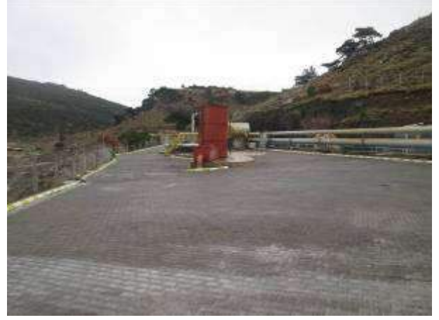
Boru Hattı ve Re-Enjeksiyon Pompası 1
