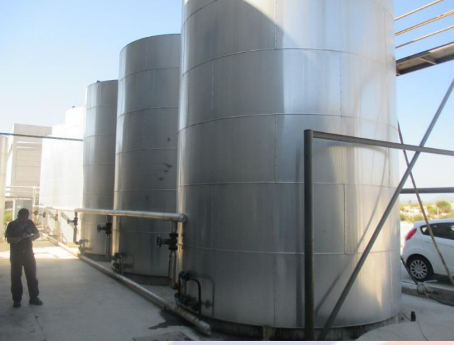
62m3 Paslanmaz Tank
